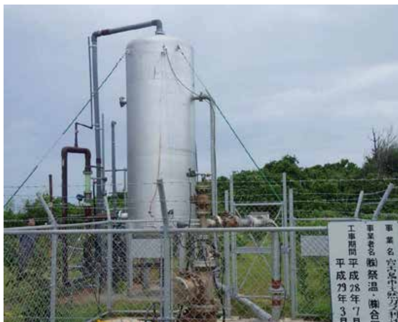
宮古 R-1 号井 坑井周辺(坑井とセパレーター)
