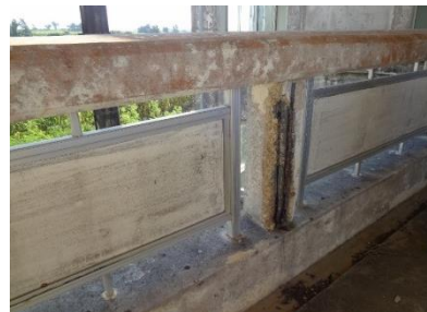
▲鉄筋が暴露した渡り廊下の手すり (伊良部庁舎)
