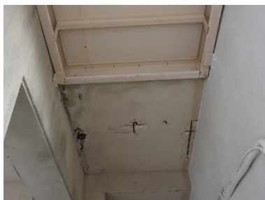
▲天井の剥離（平良第二庁舎）
