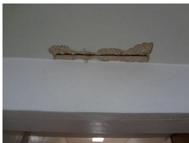
▲スラブの剥離（上水道庁舎）
